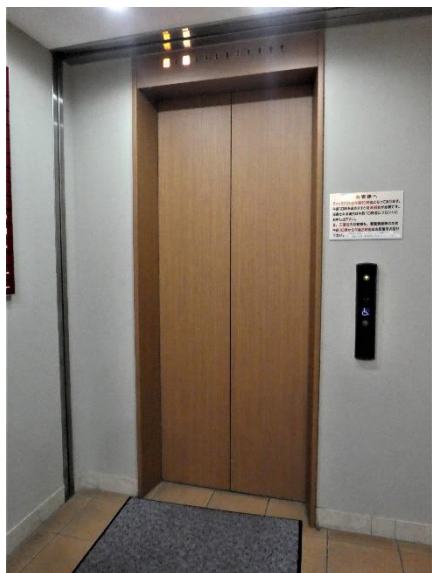
エレベーター
