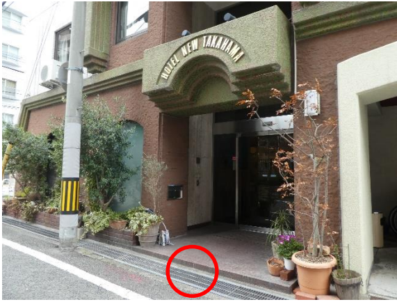
入口自動ドア。 約 7 cmの段差とグレーチング。
